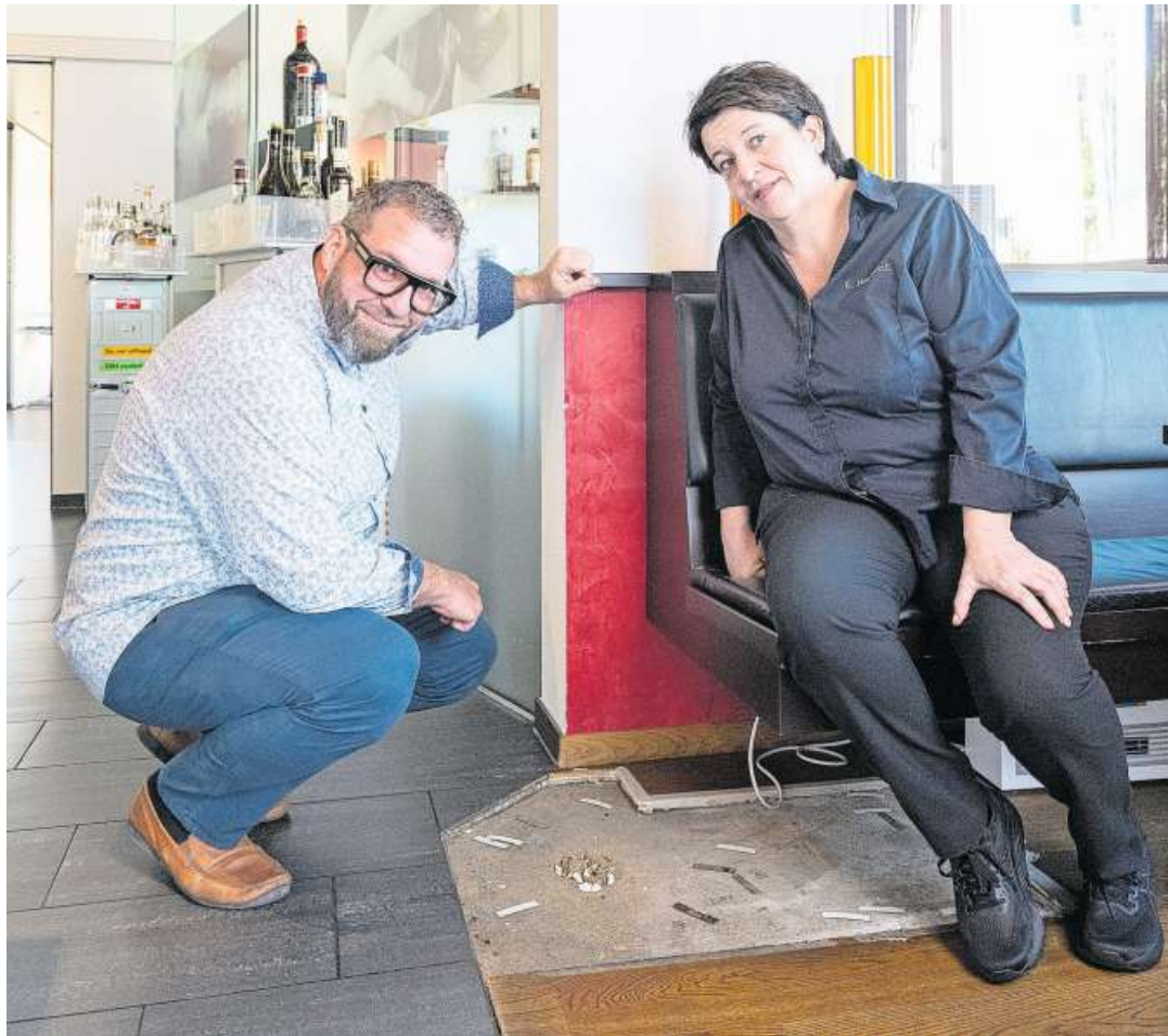
Vom Wasserschaden ist oberflächlich nicht viel zu sehen: Michael Hauenstein und Karin Hauenstein-Birchmeier zeigen im Restaurant «Sonne» die Ecke, in der sich das Parkett gehoben hat.
