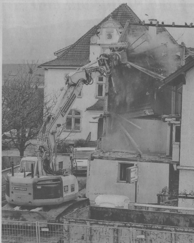
Der alte Anbau vom «Weissen Wind» wurde am 3. Februar abgerissen BILD: ZVG/URS FREY
